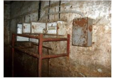
Загальний вид корозійного ураження поверхонь контрольно-пускового електроустаткування корівника
