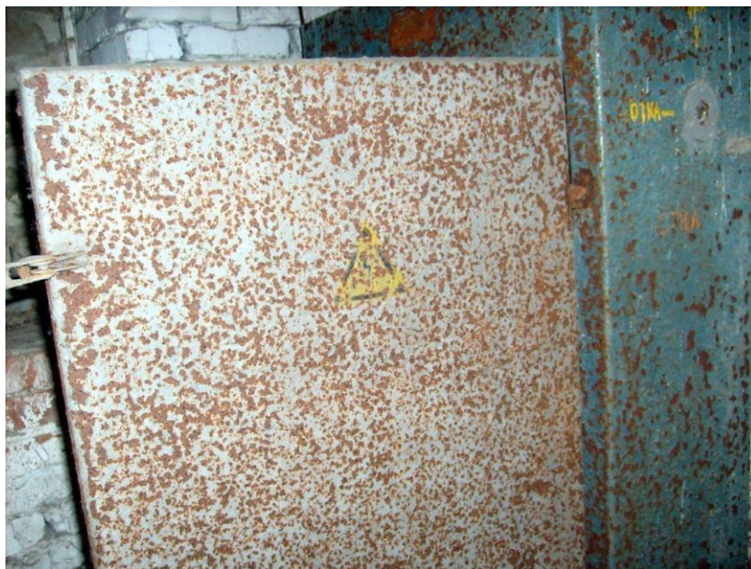
Рисунок 1.17 – Руйнування ЛФП та корозія на дверцятах електророзподільного щита
