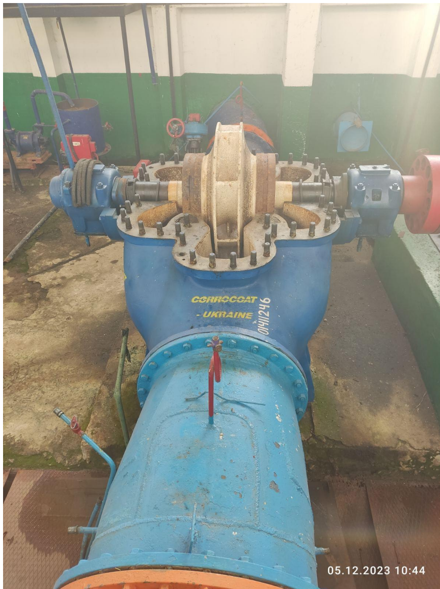
Рисунок 2.9 – ПНС–5. Насосно-силове обладнання. Насоси Д 6300/80 . Фото автора (05.12.2023 р.)
