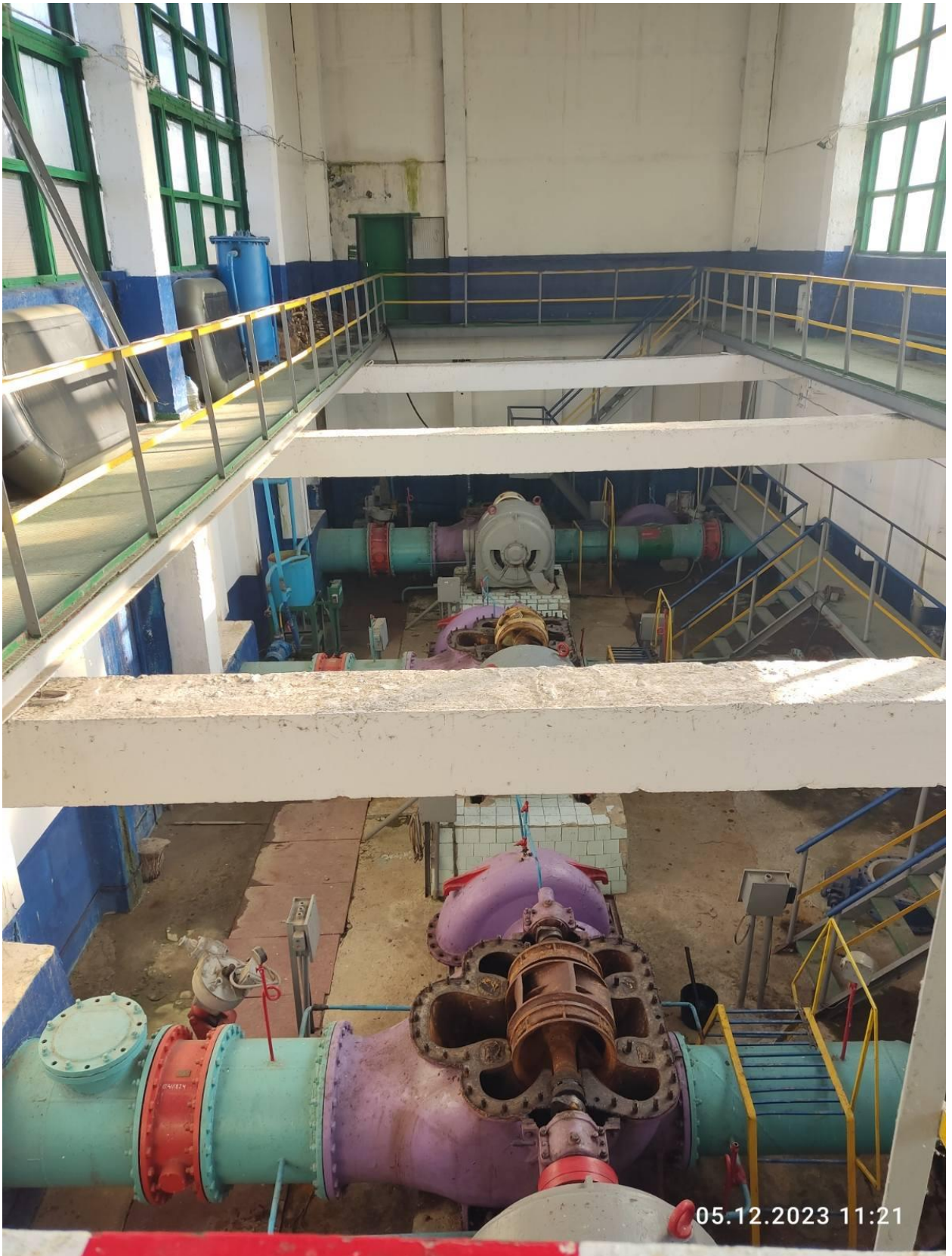
Рисунок 2.6 – ГНС–4. Насосно-силове обладнання. Насоси Д 6300/27 . Фото автора (05.12.2023 р.)
