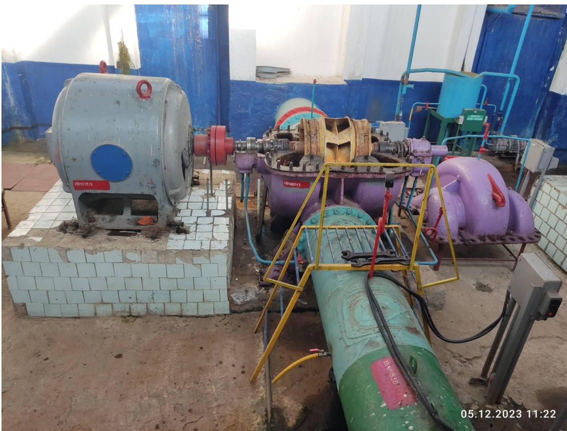
Рисунок 2.5 – ГНС–4. Насосно-силове обладнання. Фото автора (05.12.2023 р.),
