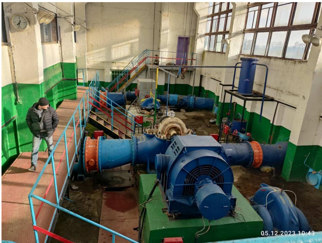
Рисунок 2.8 – ПНС–5. Насосно-силове обладнання. Фото автора (05.12.2023 р.),
