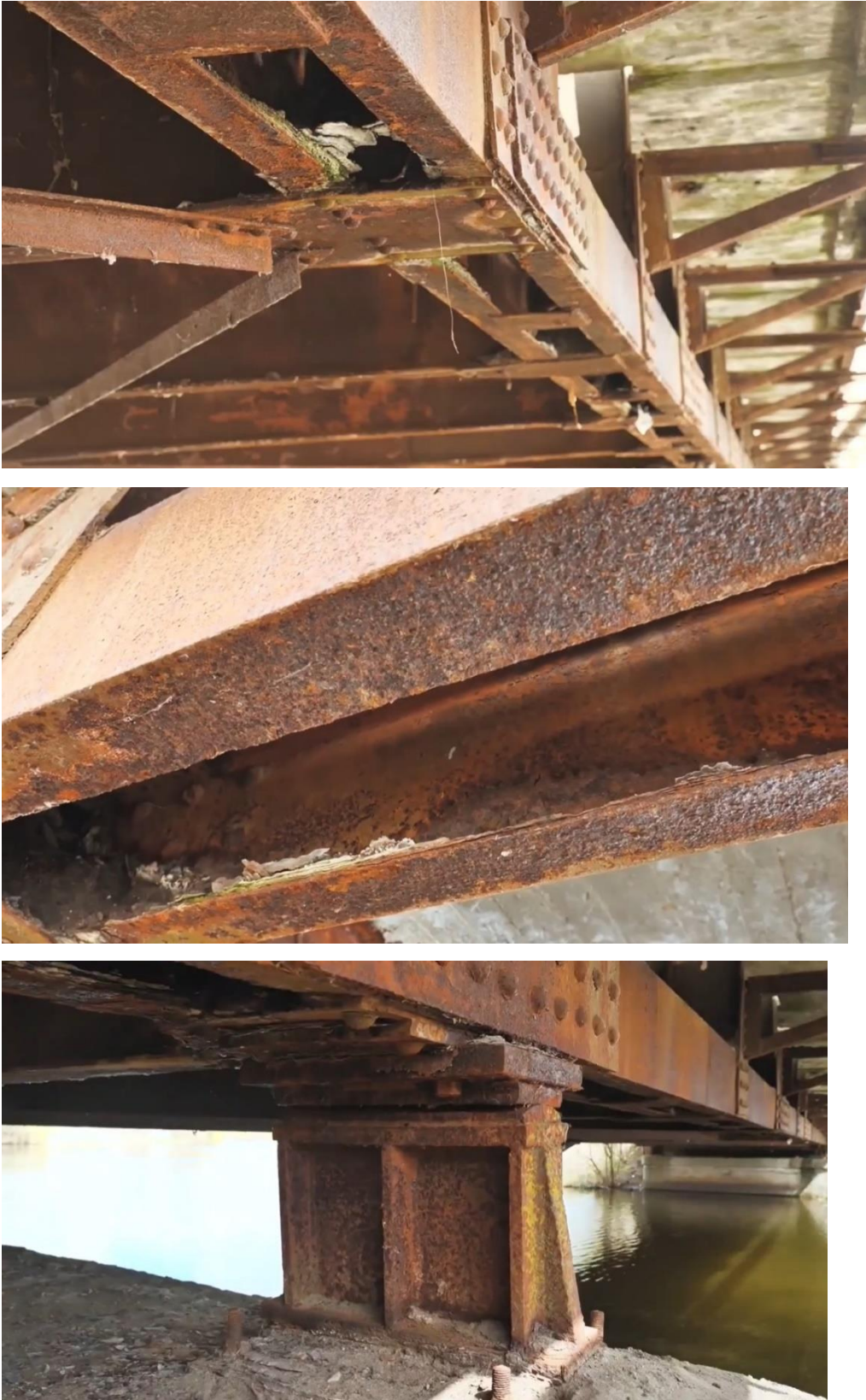
Рисунок 5.1 – Візуальний стан металевих конструкцій мосту через річку Гуйва в мю Андрушівка [9]
