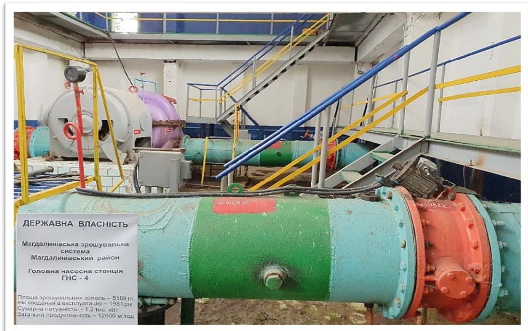
Рисунок 2.2 – Головна насосна станція ГНС – 4.
