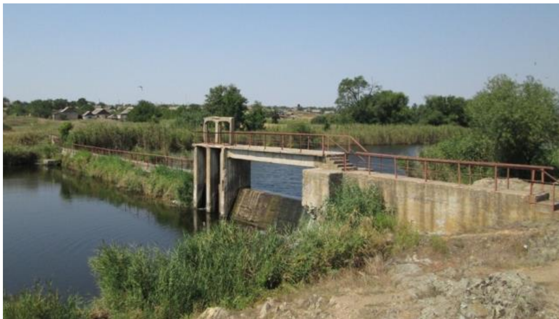
Рисунок 5 Зруйновані шлюзи Лошкарівської дамби
