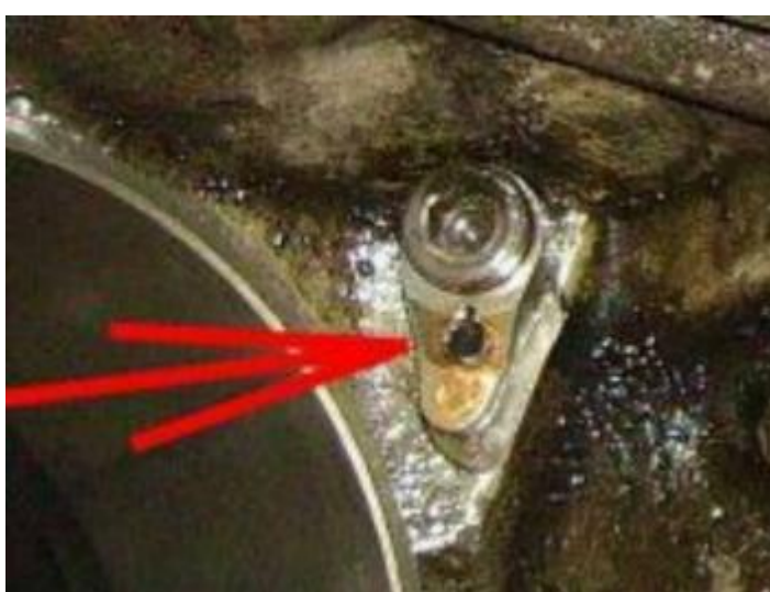
Рисунок 2.5 – Дефект у вигляді зламаної масляної трубки
