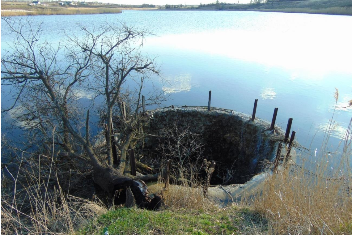
Рисунок 3.4. Фактичний стан неналежного рівня технічної експлуатації водоскидної споруди та необхідність її реконструкції
