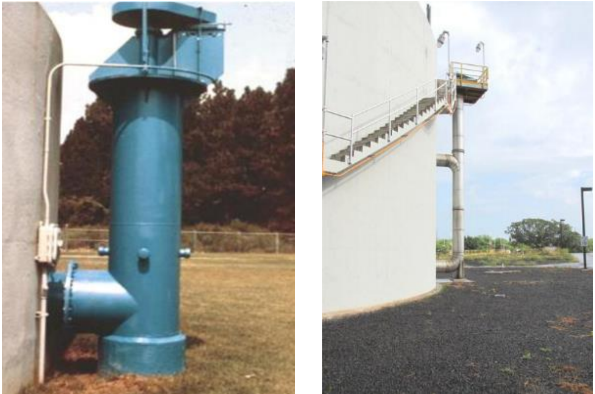
Рисунок 2.4 - Зовнішня циркуляційна труба метантенка
