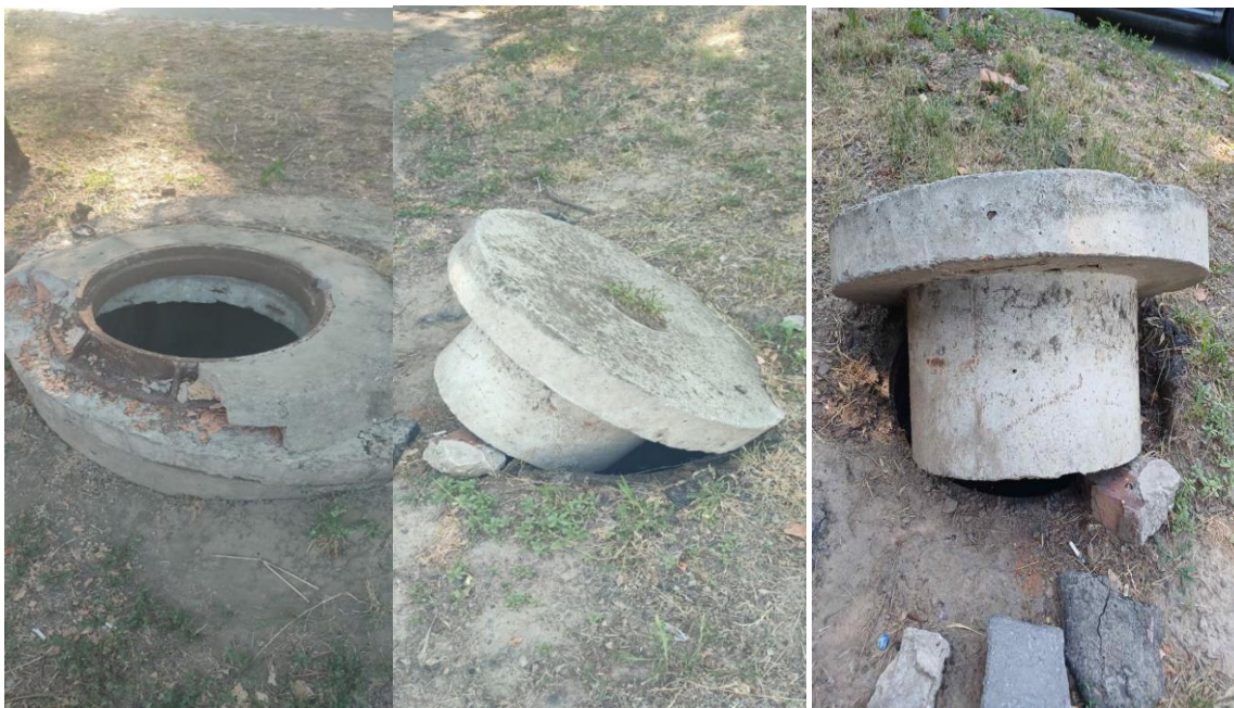
Рис. 3.8 – небезпечні люки на вул. Орлівська
