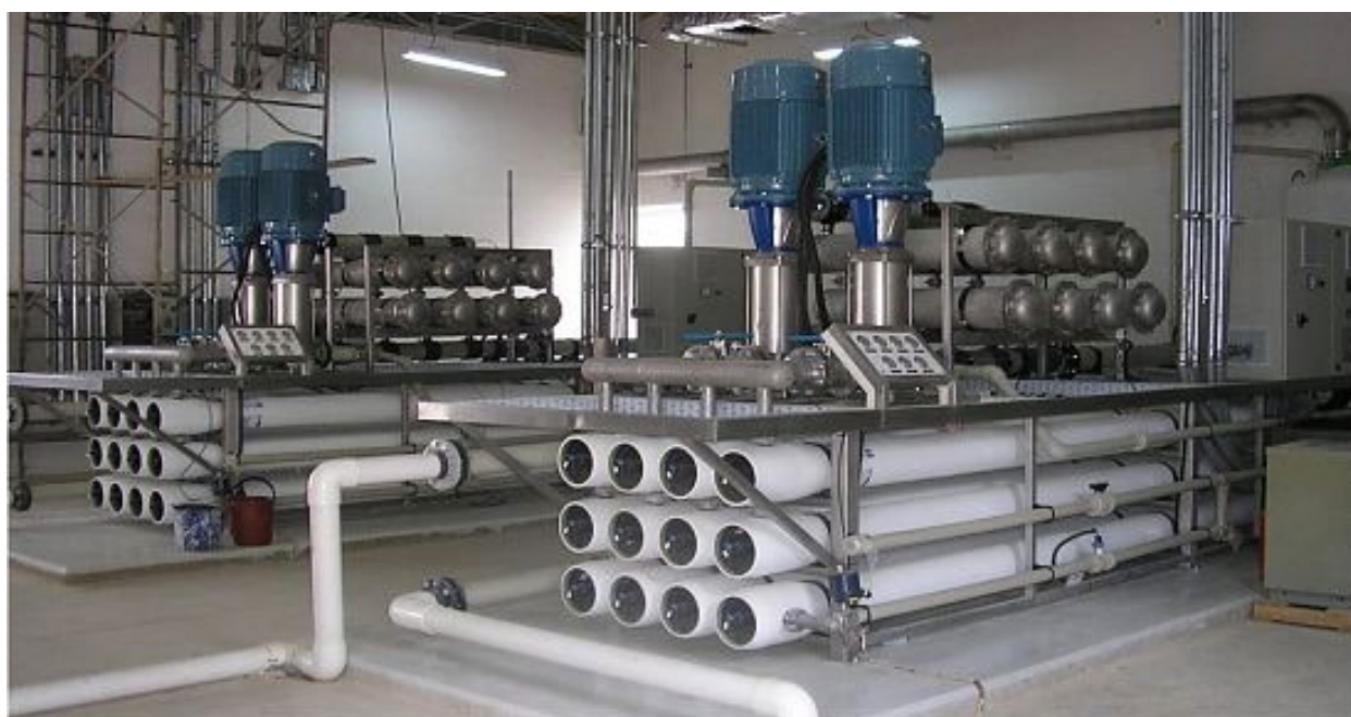
Рис. 19. Установки заворотного осмосу компанії Лакта-Сервіс [22]
