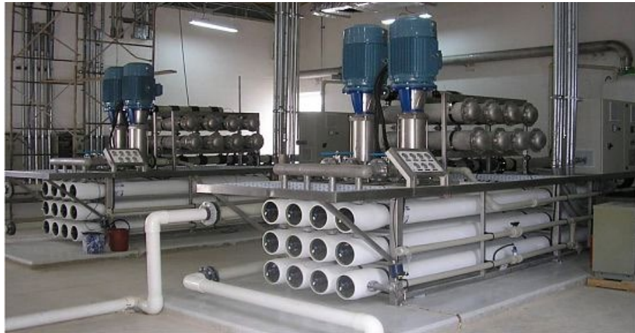
Рис. 19. Установки зворотного осмосу компанії Лакта-Сервіс [22]
