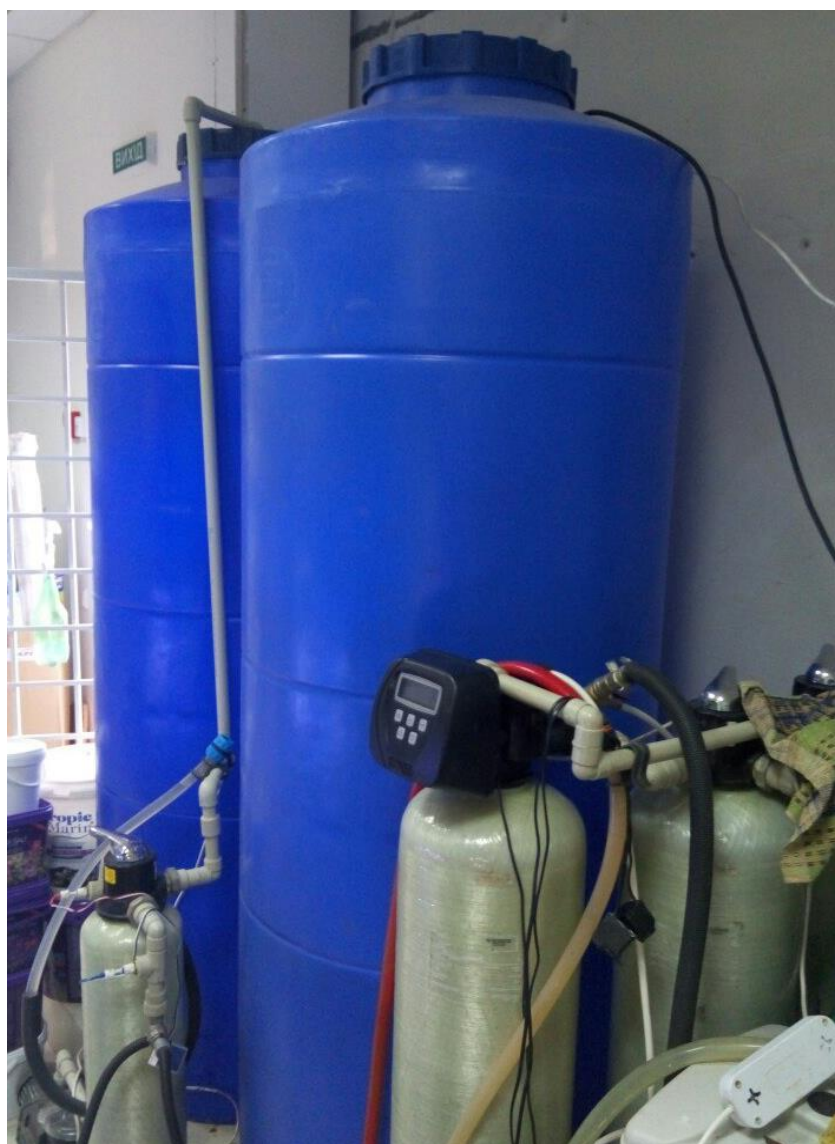
Рис. 6. Фрагмент системи для очищення води
