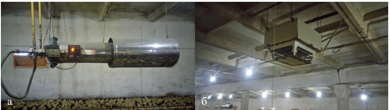
Рис. 4. Теплогенератор (а) та франкоіл з лопатями (б), що використовуються для опалення корпусів пташників на відділенні «Нетельне» ТОВ «ПК «Дніпровський»
