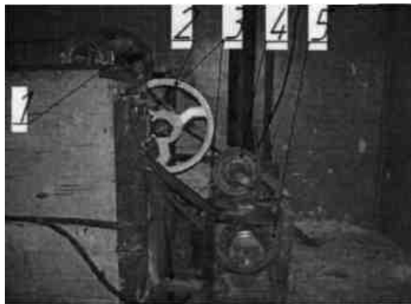
Рисунок 3.3. Загальний вигляд приводної станції (вигляд збоку):
