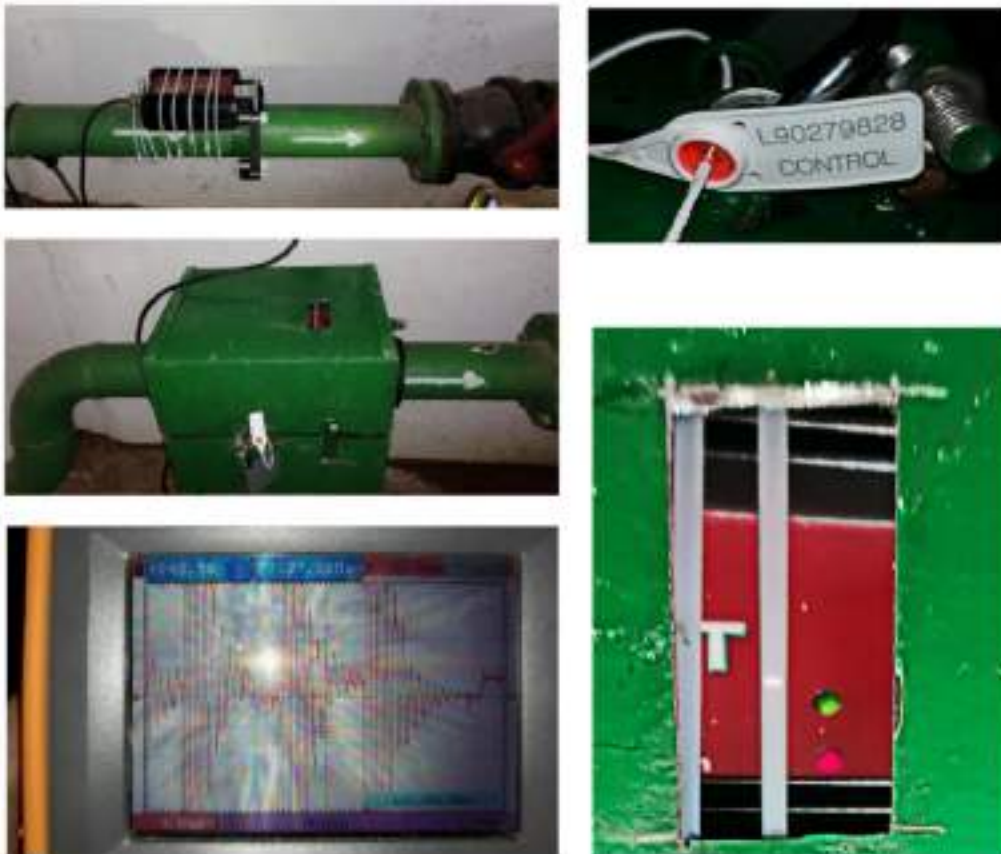
Рисунок 2. Фото контрольних елементів в процесі монтажу і запуску приладу «HydroFLOW»
