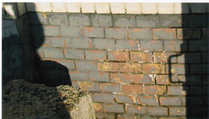
Рис. 5. Локальні тріщини конструкції стін наземної частини будівлі
