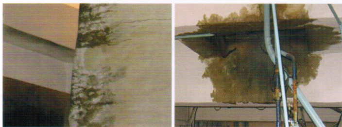
Рис. 7. Замаслювання поверхні та тіла конструкцій
