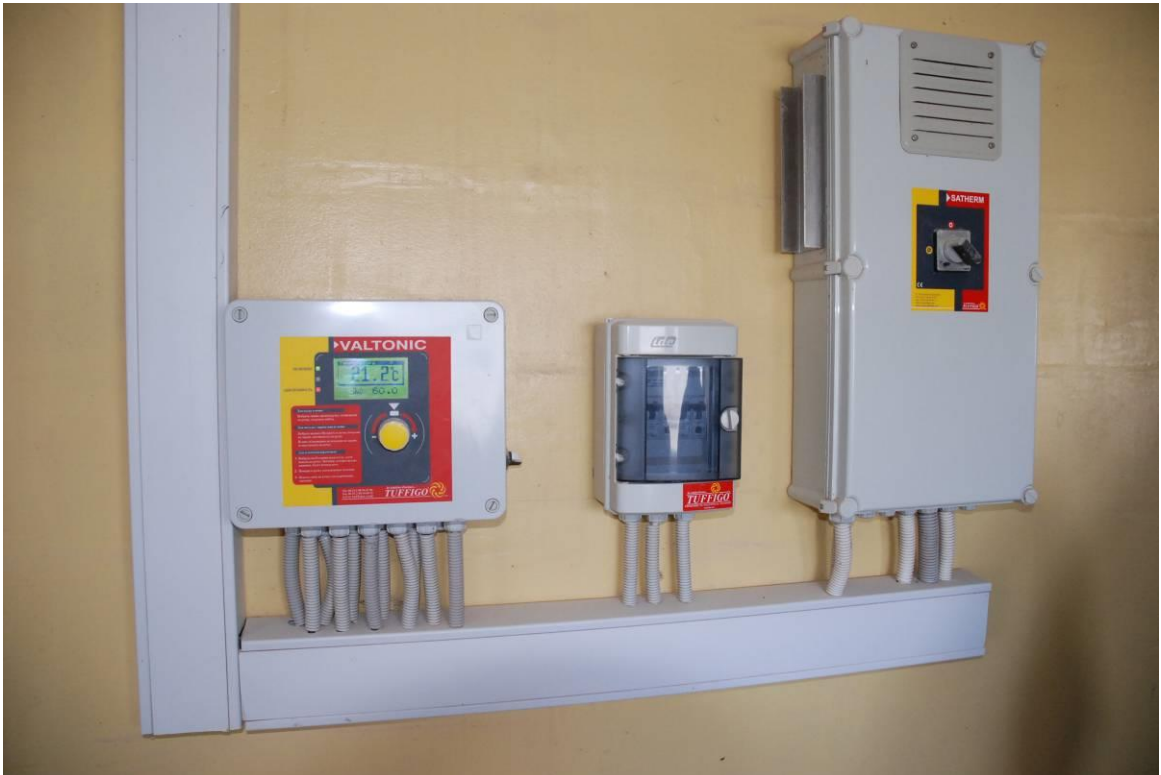
Рис. 17. Процес комп'ютерного контролю мікроклімату у приміщенні за допомогою системи "Клімат контроль"
