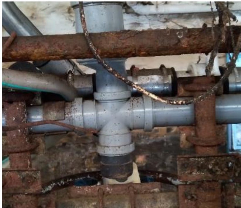
Рисунок 3.6 – Хрестовина вакуумної лінії яка заглушена в точці зливу конденсату
