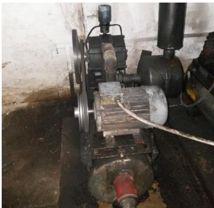
Рисунок 3.1 – Неправильно проведені розбирально-складальні роботи при обслуговуванні або ремонті вакуумної установки
