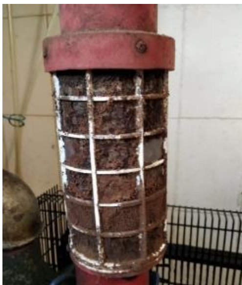
Рисунок 3.4 – Фільтр пастка ресивера вакуумного насоса
