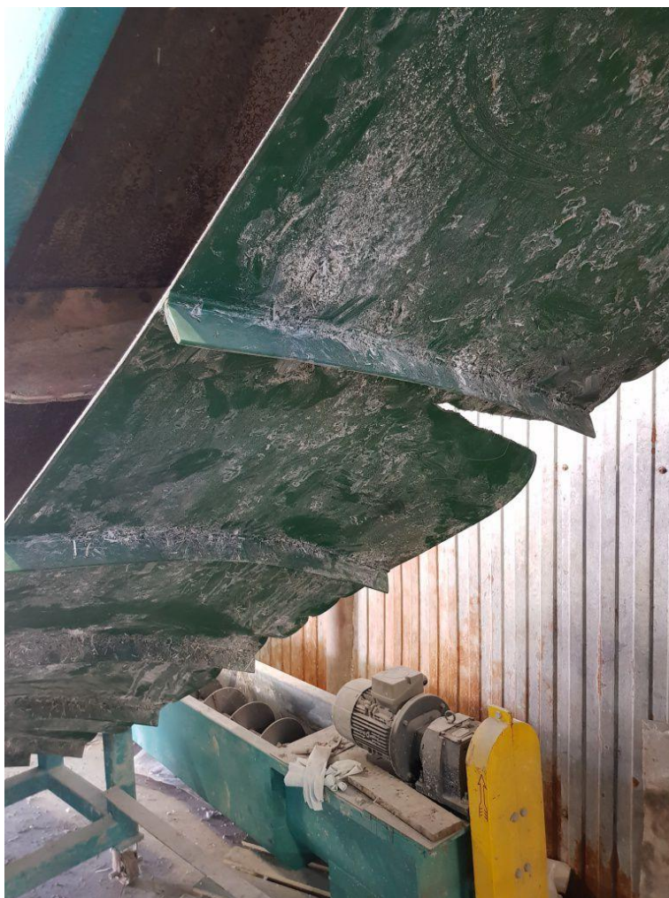
Рис. 1.16. Дефект стрічки (надрив)
