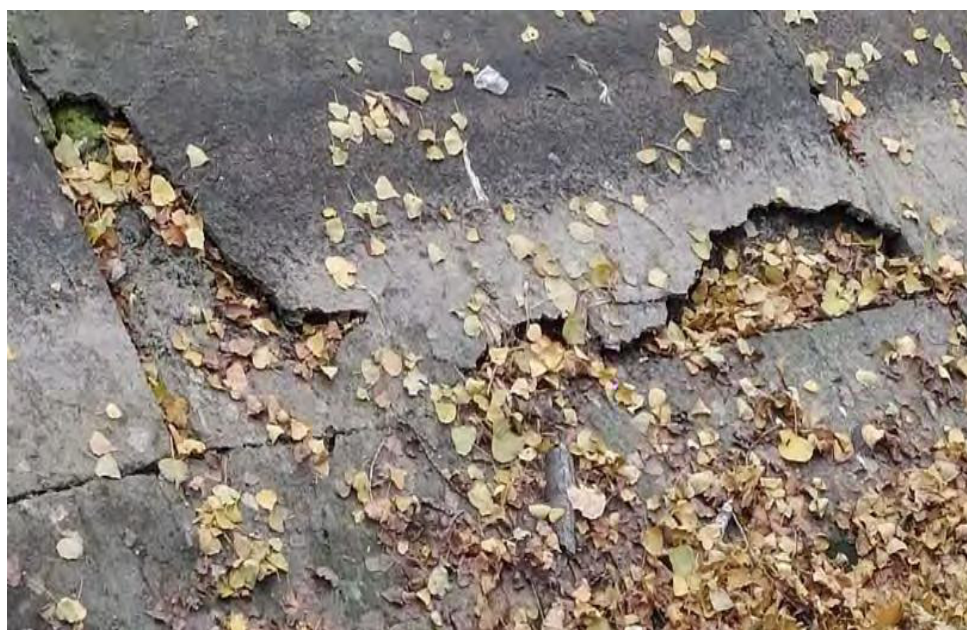
Рис. 3. Руйнування окремих елементів споруди
