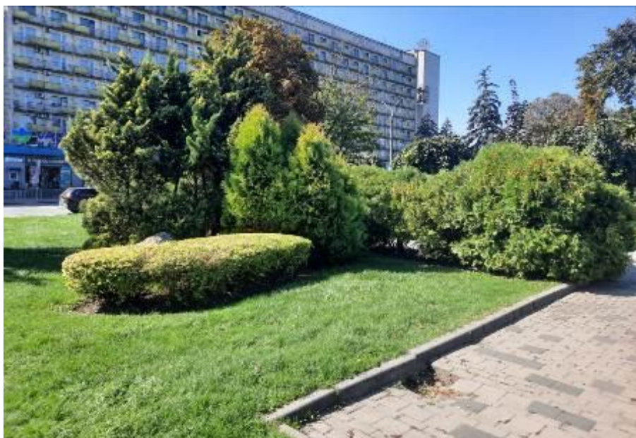
Рис. 3.20 – Плиткове покриття, що потребує часткового ремонту
