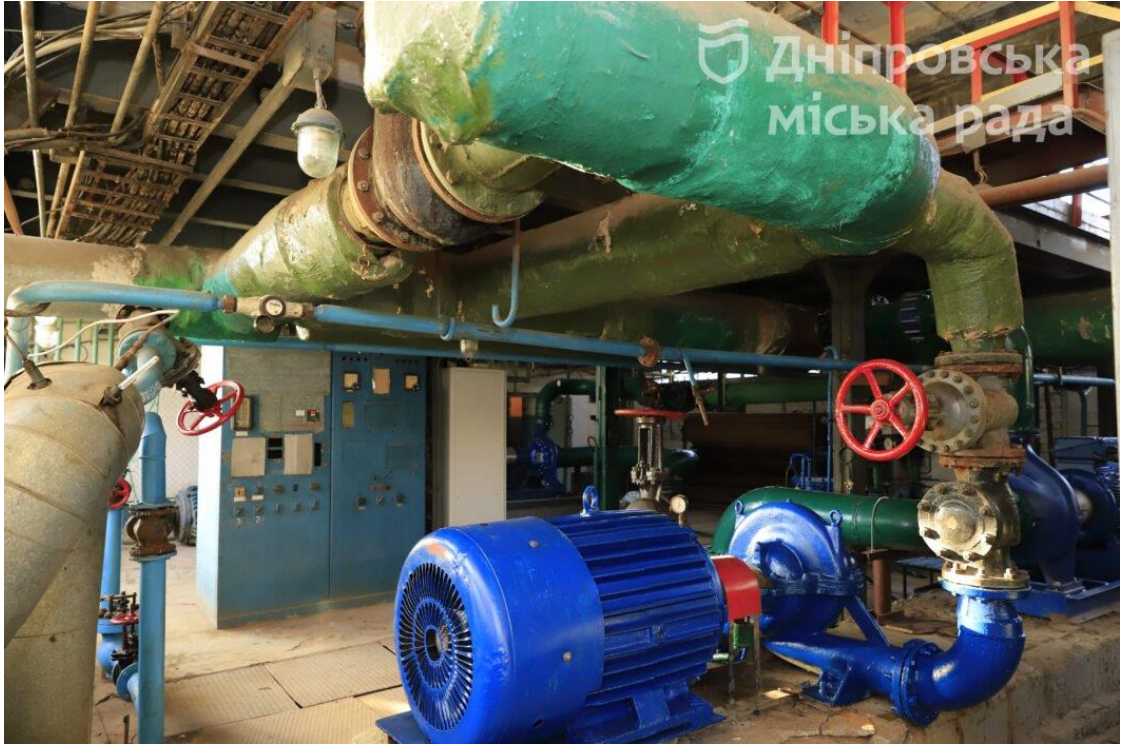
Рисунок Мережний насос теплопостачання»
