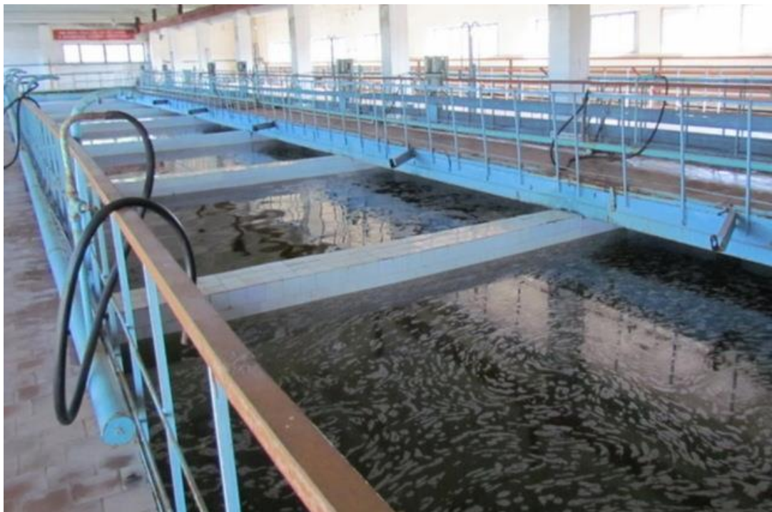
Рисунок Кайдацька насосно-фільтрувальна станція»
