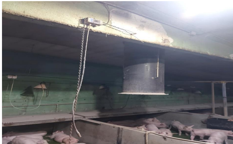
Рис. 6. Витяжні шахти вентиляційної системи
