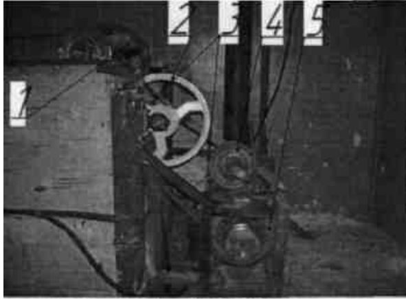
Рисунок 3.3. - Загальний вигляд приводної станції (вигляд збоку):
