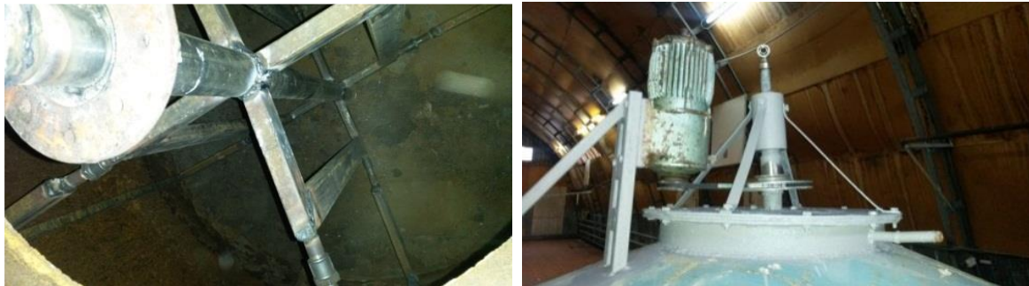
Рисунок 3.5 – Загальний вигляд теплообмінника-змішувача
