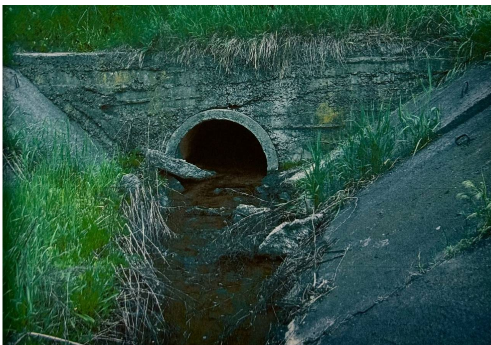
Рисунок 4.3. – Скид дренажу з з/бет. труби в р. Інгулець на КМ 311,27. Місце відбору проб № 8. [22]
