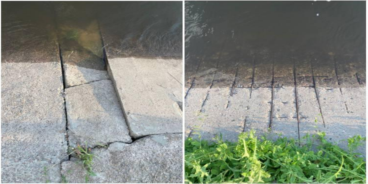
Рисунок 2.8 - Пошкодження облицювання Кільченської зрошувальної мережі
