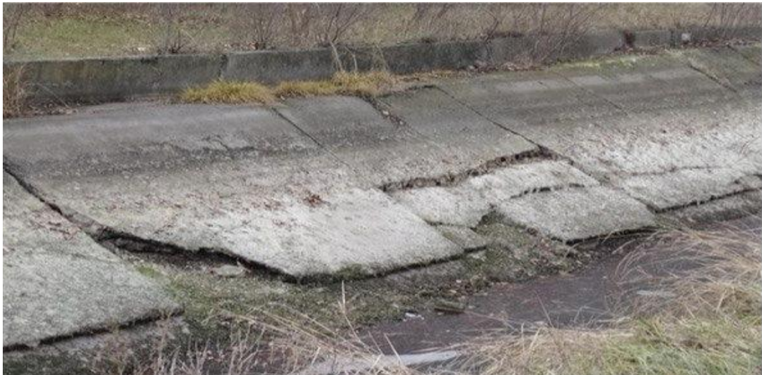
Рисунок 2.5 - Зсув плит, відсутність фрагменту плит, пошкодження поверхневого шару
