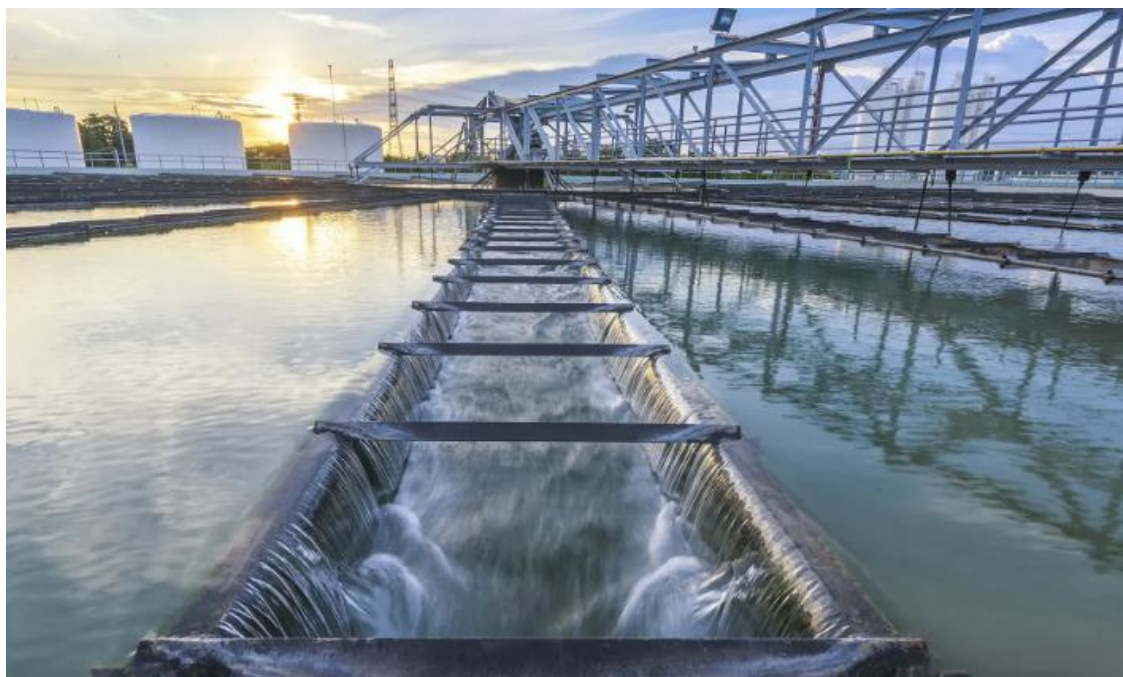
Рисунок 3.3 – Водозабірна споруда на річці Кривий Торєць
