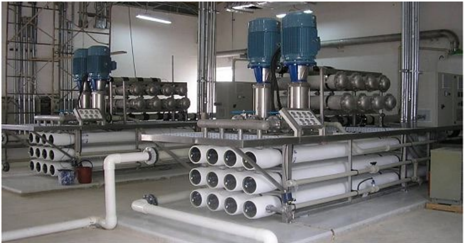
Рис. 19. Установки зворотного осмосу компанії Лакта-Сервіс [22]
