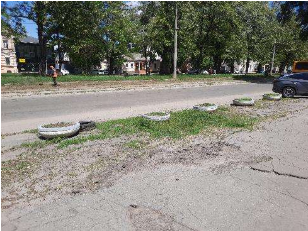
Рисунок 3.8 – Порожні бетонні квіткарки з елементами зруйнованого дорожнього покриття пішохідної частини дослідного об'єкту
