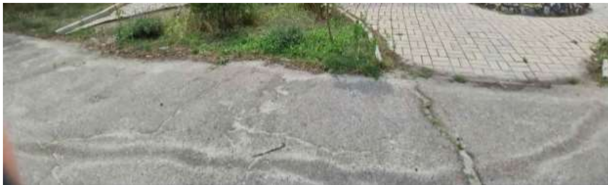
Рис. 3.3. Зруйноване асфальтне покриття
