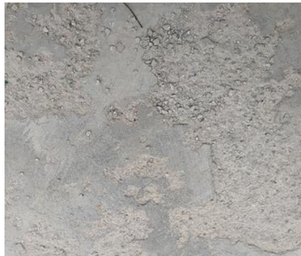
Рис. 2. Пошкодження бетонної поверхні досліджуваної ділянки
