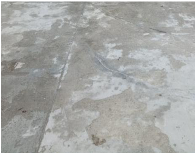
Рис. 1. Ділянка пошкодженого бетонного покриття
