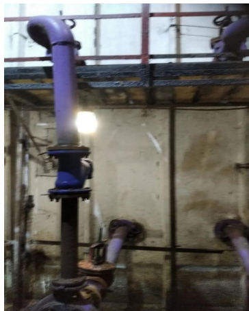
Рисунок 2.4 - Каналізаційна насосна станція
