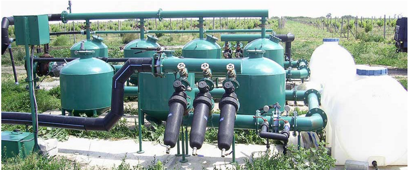
Рисунок 4.3 – Станція підготовки води: піщано-гравійні фільтри
