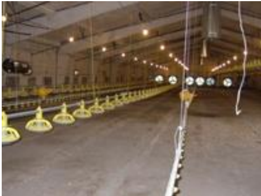
Фото 1. Внутрішнє обладнання пташник для утримання птиці.
